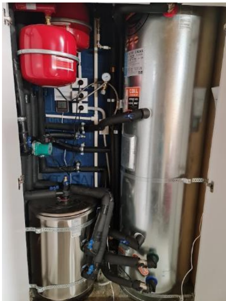
The heating / cooling cylinder to the left of the domestic HWC. Der Heiz-/Kühlspeicher links vom häuslichen Warmwasserbereiter.
