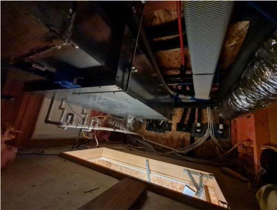
Photo showing the MVHR system installed in the ceiling space above the laundry. Foto, das das im Deckenraum über der Wäscherei installierte MVHR-System zeigt.
