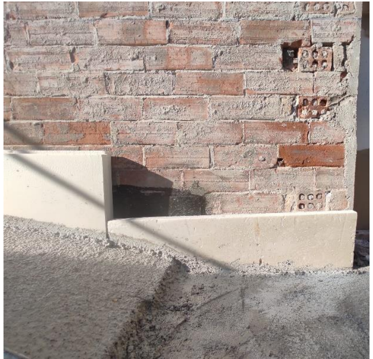
Rotura de puente térmico en solera
