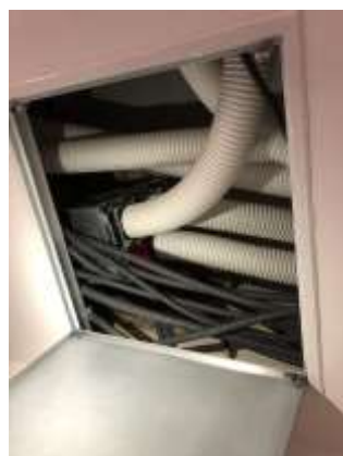
Caisson et distribution d'air en logements par des gaines PEHD.
