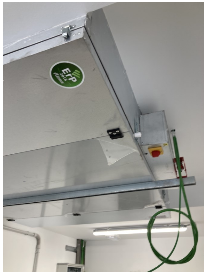
Fotografía de obra. Unidades interiores de climatización.
