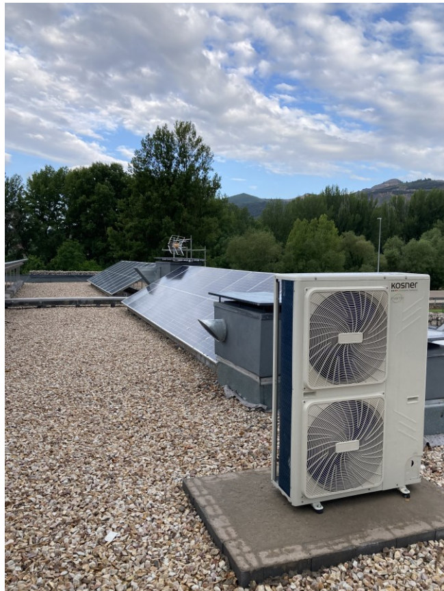
Fotografía de obra. Instalaciones en cubierta.
