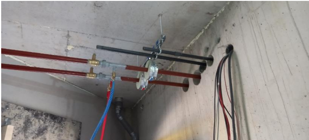
Figure 30: Panoplie de chauffage en sous-station
