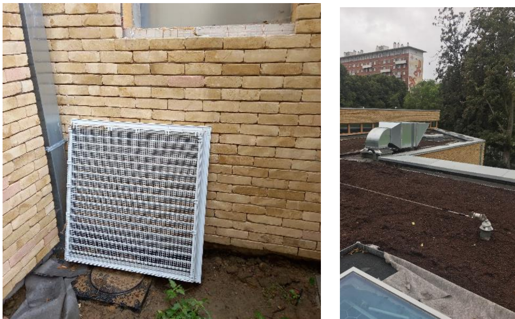
Figure 26: Prise d'air neuf en cours de pose – rejet d'air neuf en toiture
