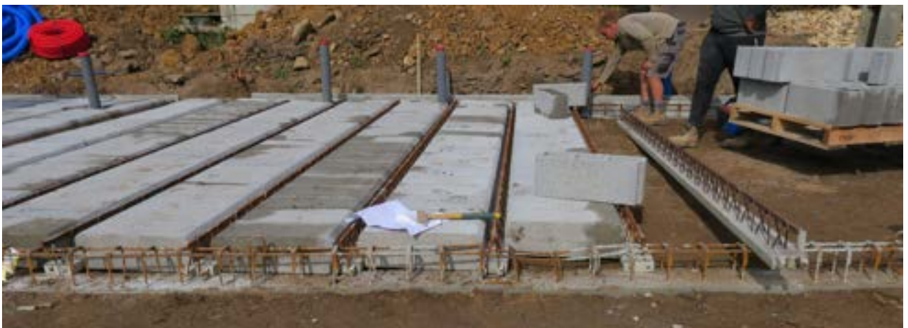
16 : Photographie de la dalle poutrelles-hourdis sur les fondations, en début de chantier
