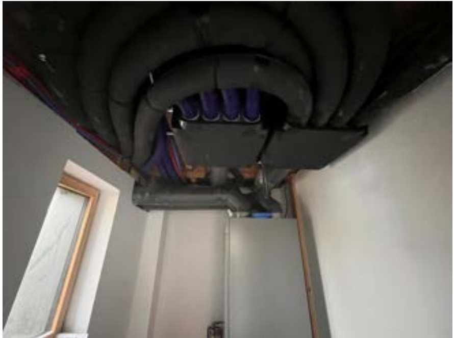
33 : Réseaux depuis la CTA : gaines AN/AR, départs de gaines vers les caissons de répartition.
