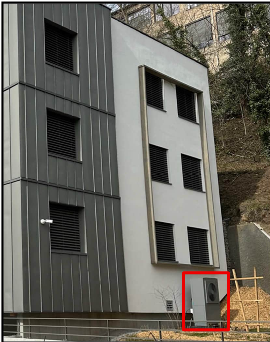
Le ballon est alimenté par une unité extérieure se situant sur une dalle, en façade Sud-Est.
