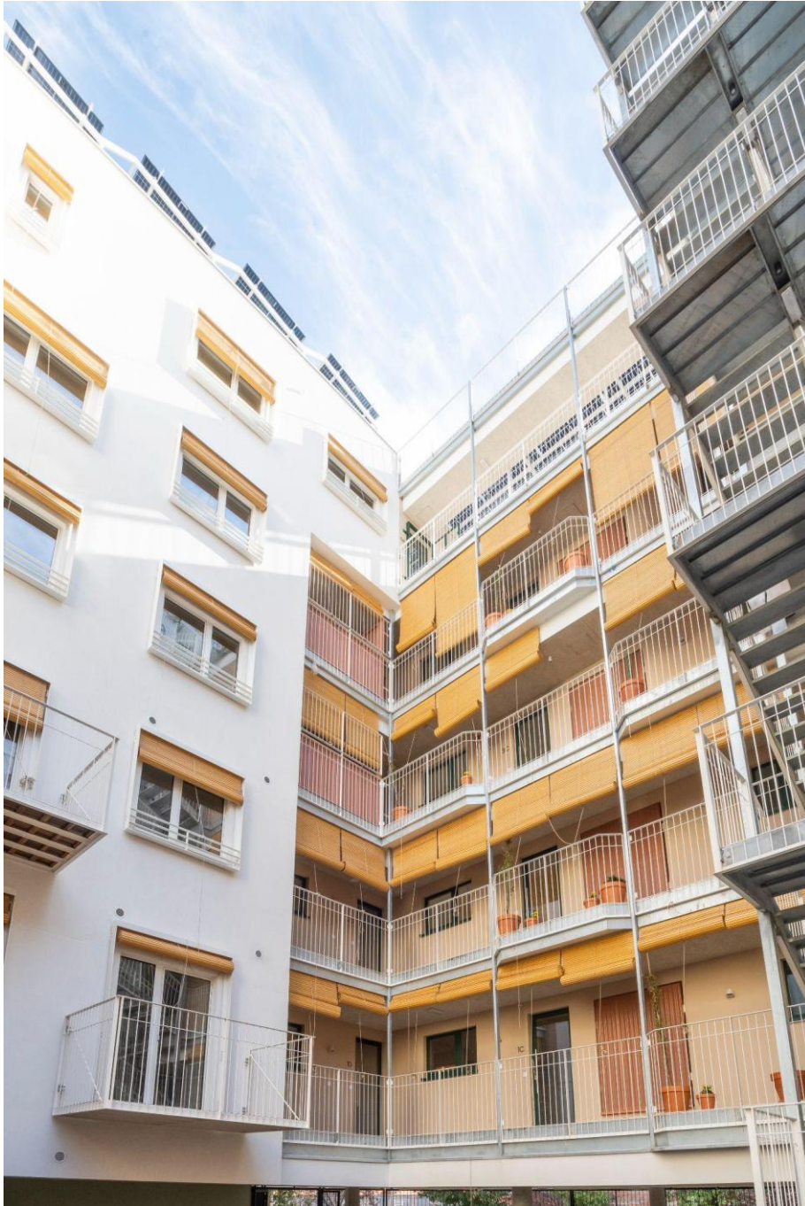
Patio interior. La circulación del edificio se realiza por el patio usando las corralas (corredores exteriores) , las escaleras y el ascensor. Se ven las salidas y entradas de aire de la ventilación.
