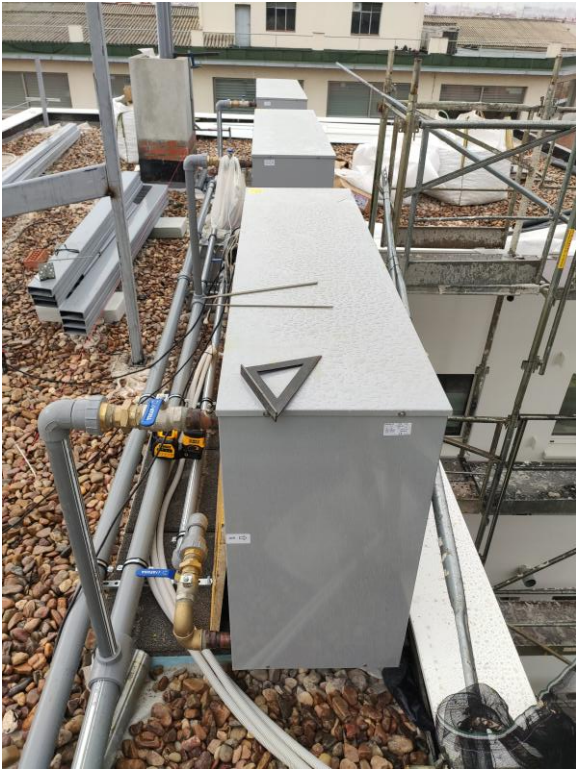
Unidades exteriores de aerotermia colocadas en la cubierta transitable bajo la estructura de los panles fotovoltaicos.
