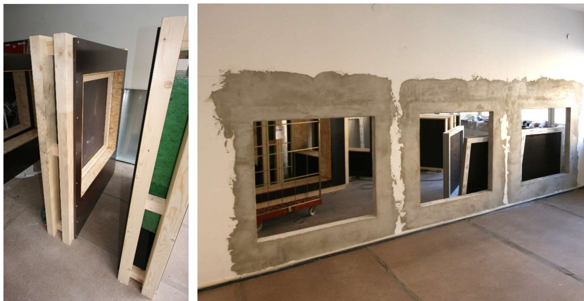
Abbildung 1: Wandsysteme in Holz- (links) und Massivbau (rechts) für den Einbau der Fensterrahmen. Die Einbaubereiche für die Fensterrahmen haben jeweils das lichte Maß von 1030 x 1030 mm.
