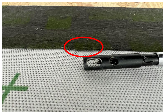
Abbildung 12: Mit einem Anemometer messbare Leckage am Übergang zwischen Bahn und Klebeband vor der Nacharbeitung. Leckage nachweisbar erst bei höheren Drücken.
