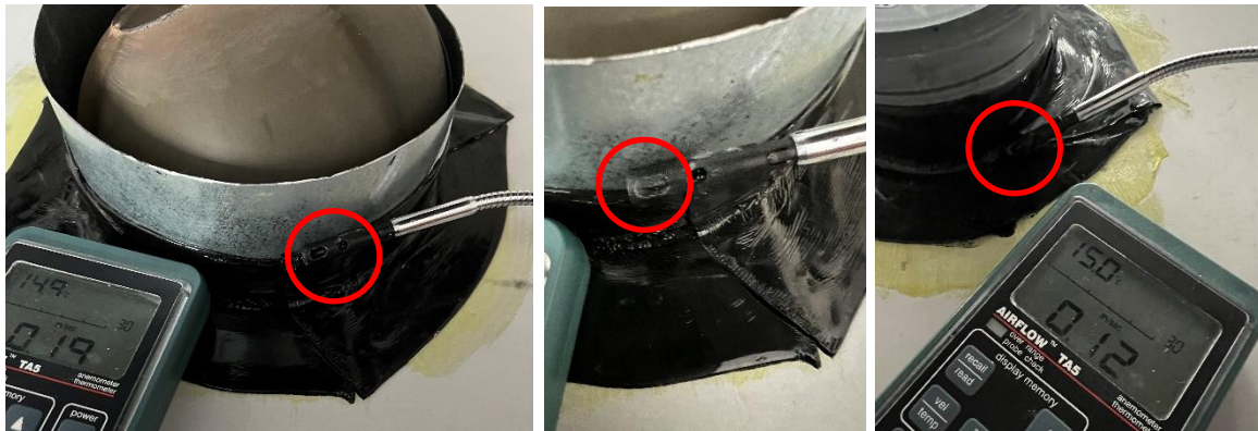
Abbildung 17: Restleckagen nachweisbar an der Verbindung zum Rohr und an den Überlappungen bei ca. 200 Pa Überdruck. Mit einem Thermoanemometer wird die Luftgeschwindigkeit an der Leckage gemessen.
