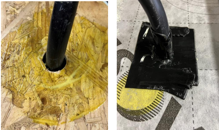
Abbildung 1: Links: Hausanschlusskabel (25 mm) mit aufgetragenem Haftvermittler „ISOVER Vario® MultiPrime“ auf Holz . Rechts: Auf der variablen Dampfbremse ISOVER Vario® KM Duplex UV wurde das Hausanschlusskabel mit ISOVER Vario® Stretch abgedichtet.
