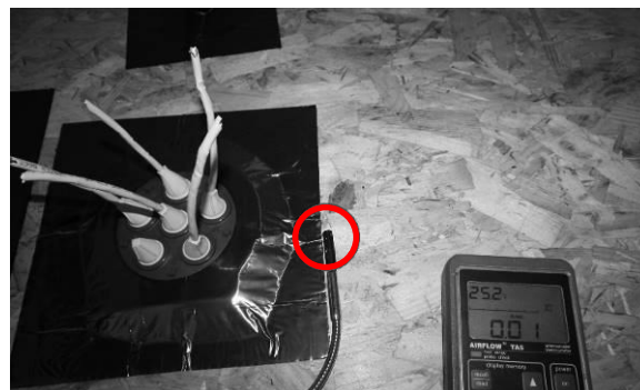
Abbildung 17: Geringe Restleckagen nachweisbar an der Verbindung zum Bauteil bei ca. 200 Pa Überdruck an der KABSEAL PRO 6 ALU 4-11 Manschette. Mit einem Thermoanemometer wird die Luftgeschwindigkeit an der Leckage gemessen.
