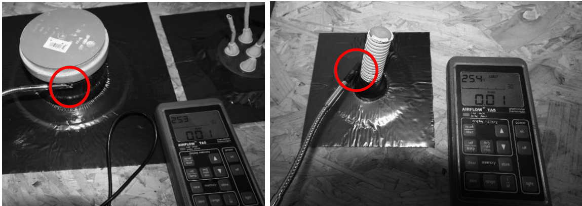
Abbildung 18: Geringe Restleckagen nachweisbar an der Verbindung des Kabels/Rohrs zum Kragen der Manschette bei ca. 200 Pa Überdruck an der KABSEAL GAS 100-110 Manschette (links) und an der KABSEAL GAS 22-25 Manschette (rechts). Bei der KABSEAL GAS 22-25 Manschette befindet die Leckage nur an der Verbindung zum Leerrohr. Mit einem Thermoanemometer wird die Luftgeschwindigkeit an der Leckage gemessen.
