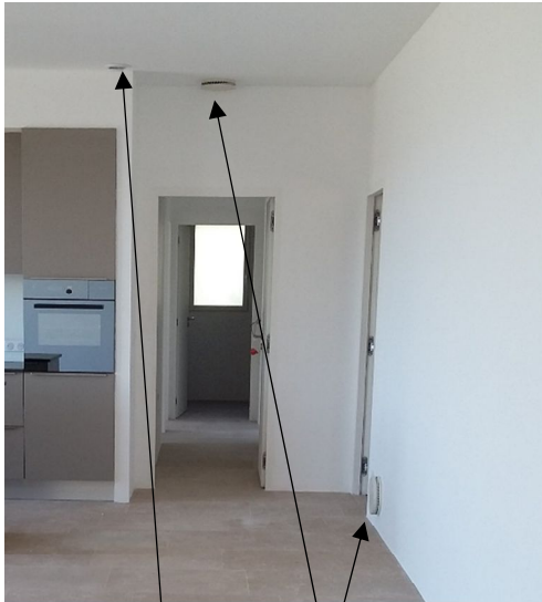
Grille de transfert acoustique pour garantir l'isolement entre pièce à vivre et pièces de nuit
