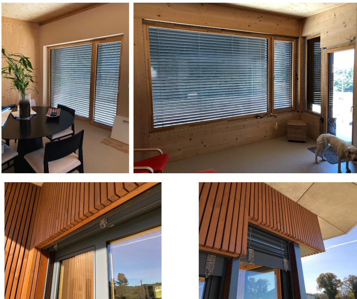
15. Vistas de las ventanas con protección solar exterior tipo Griesser Lamisol.
