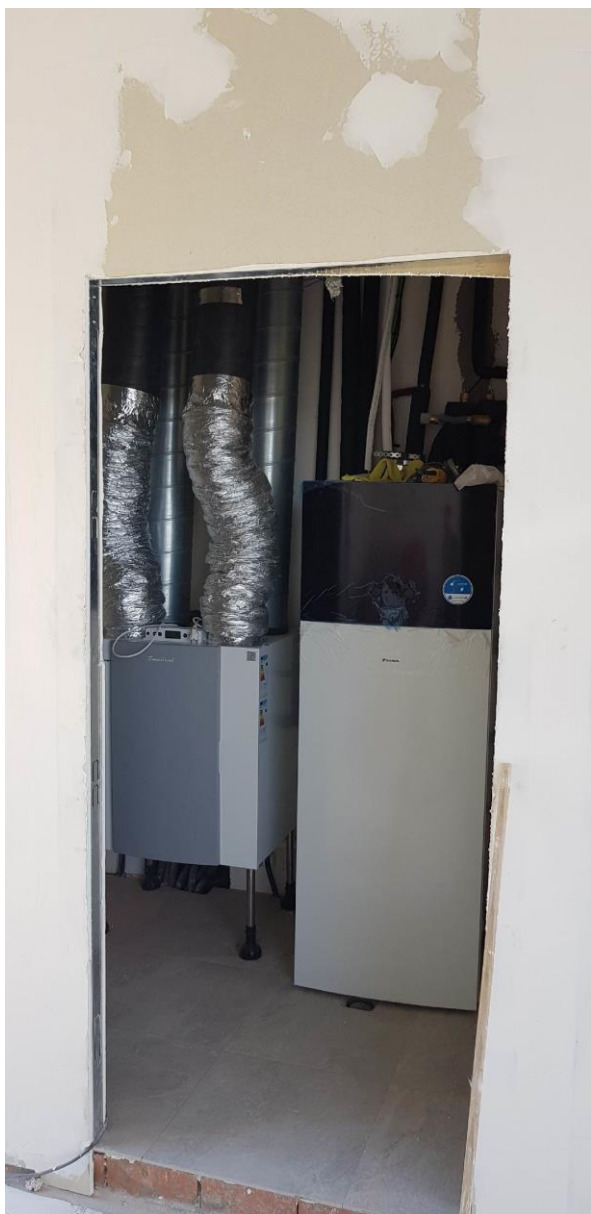
Cuarto de instalaciones: aerotermia y ventilación
