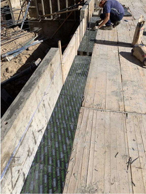
Vidrio celular en cabeza de muro de sótano
