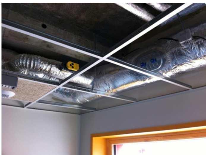
Terminaux avec registre sur détection de présence
