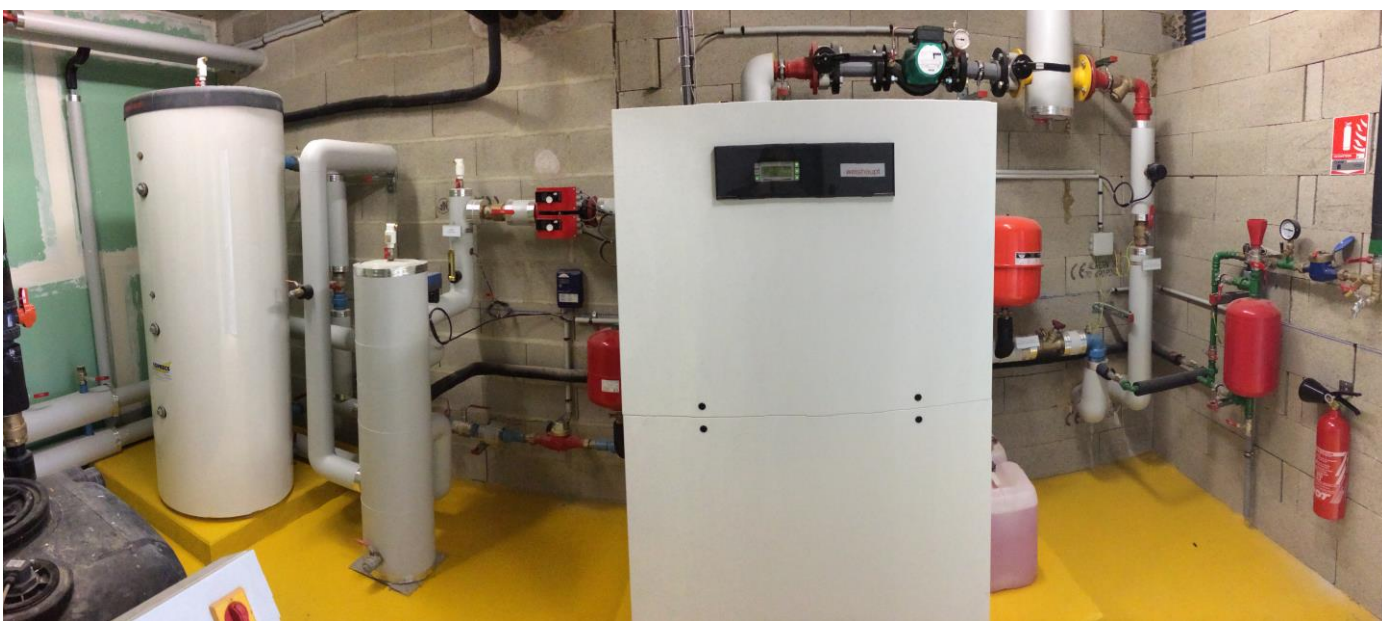
Photo panoramique de la chaufferie
